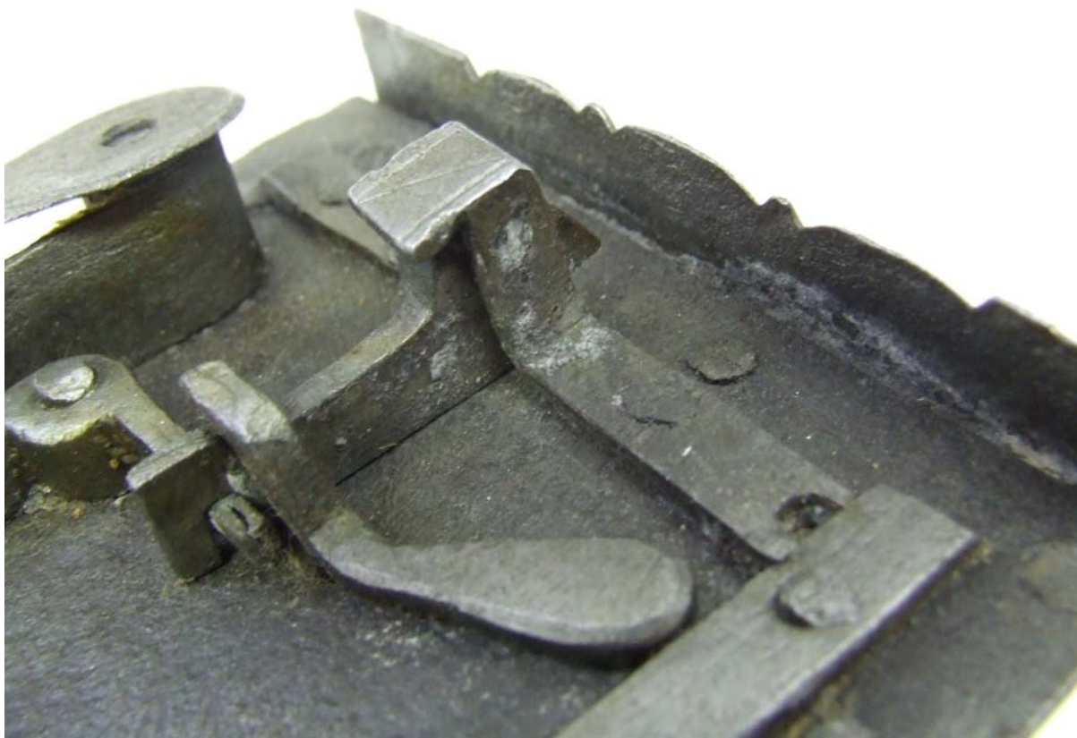
Obr. 9. Detail – Znatelná druhotná koroze v místech spojů plechů a v méně přístupných místech (v rozích). Na rámu U profilu jsou bílé a šedivé korozní produkty způsobené předcházející konzervací kyselinou fosforečnou.
